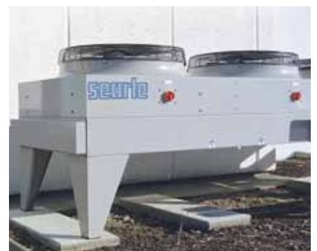
Wärmetauscher einer Glykolkühlanlage
